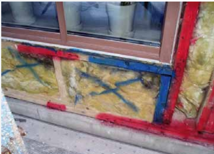
Med olika färger markerades vilka fuktskadade delar i väggkonstruktionen som skulle bytas ut helt respektive putsas eller hyvlas ner.
