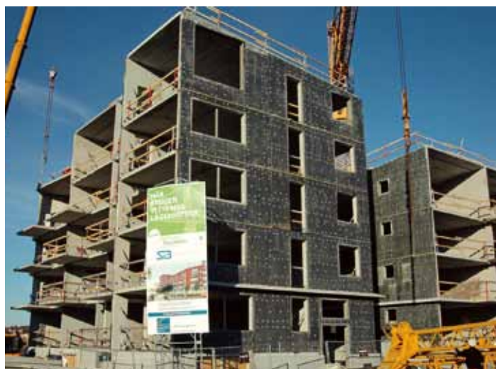
De tre huskropparna byggs av prefabricerade betongelement i fyra – sex plan. Fasaderna upp till och med det andra våningsplanet ska kläs med värmebehandlad furupanel.
