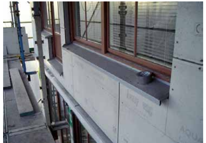
Väggarna kläddes med nytt vindskydd och därefter monterades Aquapanel-skivorna på stående perforerad ställläkt med 25 millimeters luftspalt.
